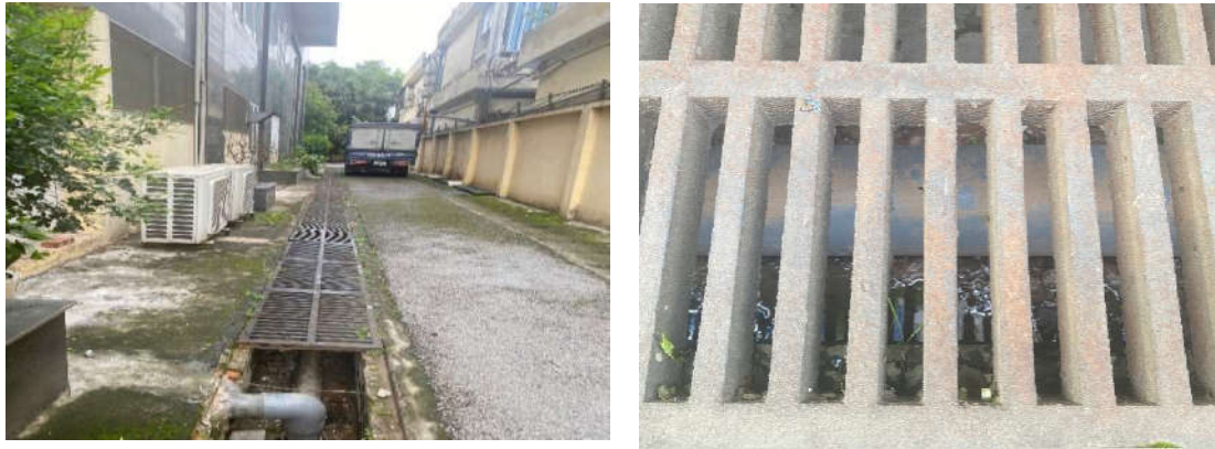
Hình 3-4. Hệ thống thu gom, thoát nước thải tại Cơ sở
