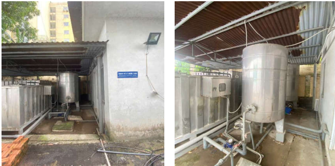
Hình 3-10. Hệ thống xử lý nước thải công suất 20m 3 /ngày đêm của cơ sở
