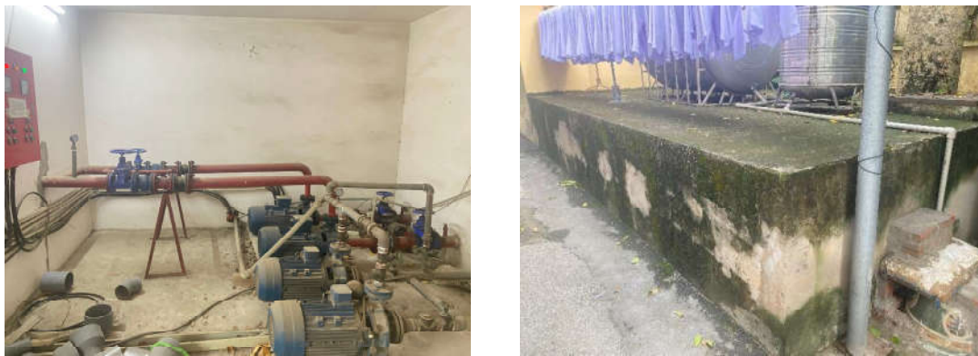
Hình 3-16. Máy bơm và bể chứa nước PCCC
