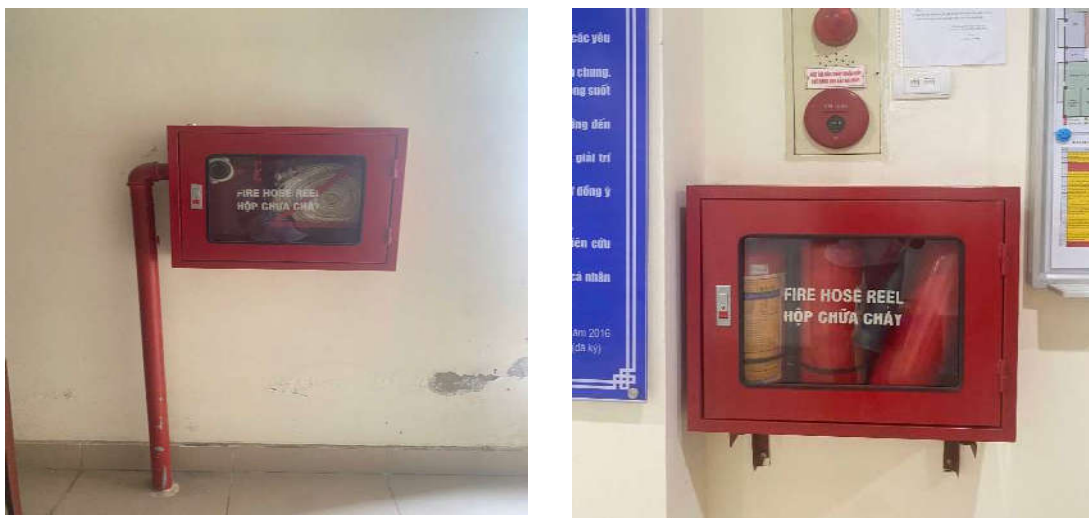
Hình 3-17. Thiết bị PCCC tại Cơ sở
