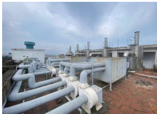
Hệ thống xử lý khí thải PTN
